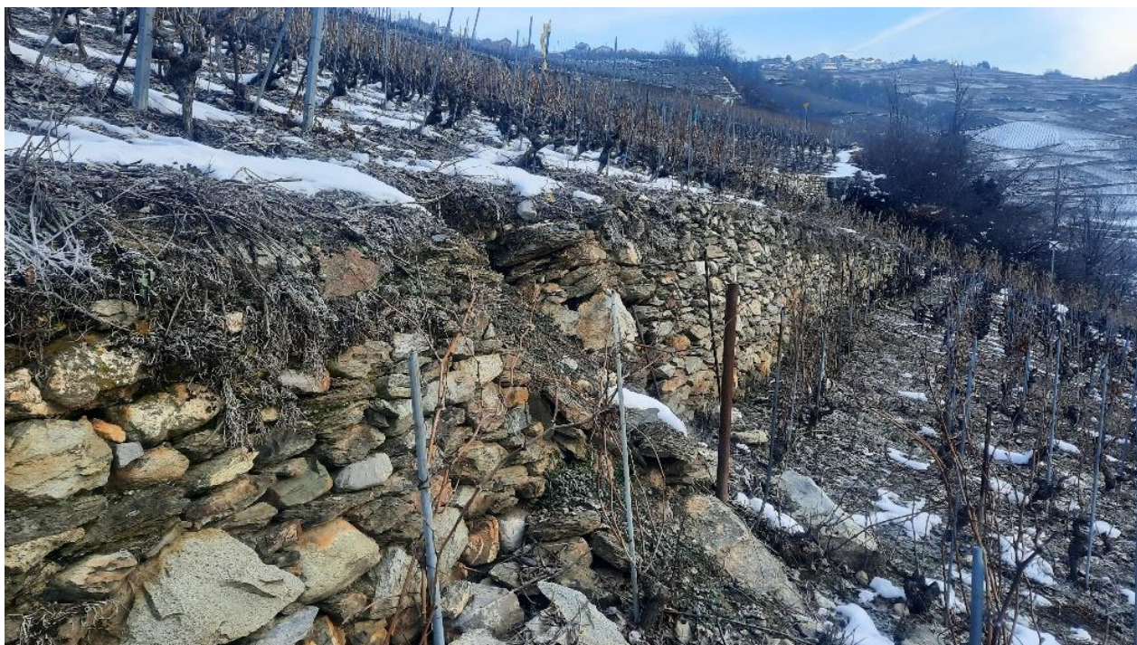
Figure 4 : Exemple de mur effondré repéré dans le vignoble
